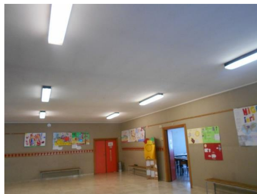
Figura 8.10 - Particolare di una plafoniera a tubi fluorescenti
