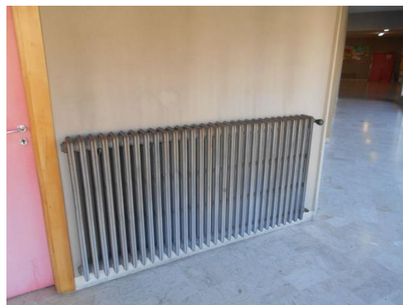
Figura 4.8 - Particolare di un radiatore in ghisa
