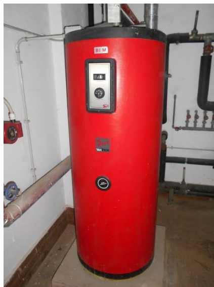
Figura 4.14 - Particolare del bollitore ad accumulo
